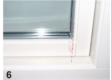
6 Linfästet placeras i fönstrets nederkant. I sidled linjeras fästet med glasöppningen enl. bild.
